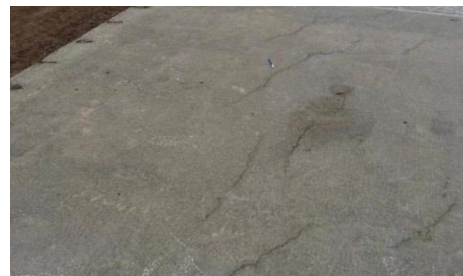
Ilustración 1. Fisuras por retracción plástica.
