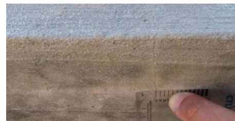
Ilustración 2. Fisuras por tensiones de origen térmico.
