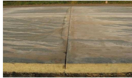
Ilustración 3. Fisuras por mala ejecución de juntas.
